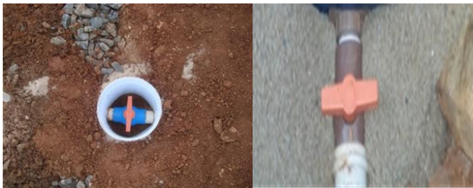
Figura 8. Registro próximo a caixa d'água e a tubulação que liga ao tanque.
