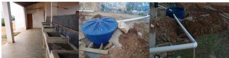
Figura 7. Local de armazenamento da água da lavanderia para passar aos tanques.
